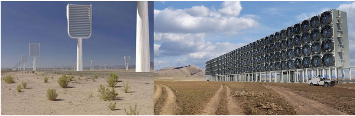
Abbildung 41: Künstliche Bäume und eine andere technische Anlage zum Einfangen von CO 2 . 164
